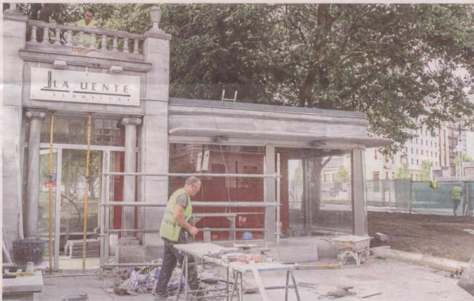
En el pabellón están siendo sustituidas las placas de mármol gris vetado que estaban deterioradas. :: ANDRÉS FERNÁNDEZ
